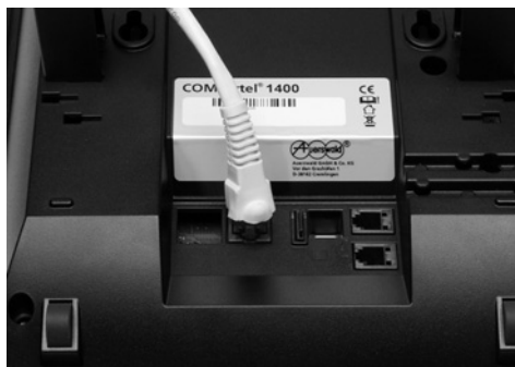
Abb. 7: Anschluss an die TK-Anlage
